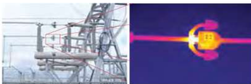
Figure 12-1 : Défaut détecté dans une installation haute tension [10]
